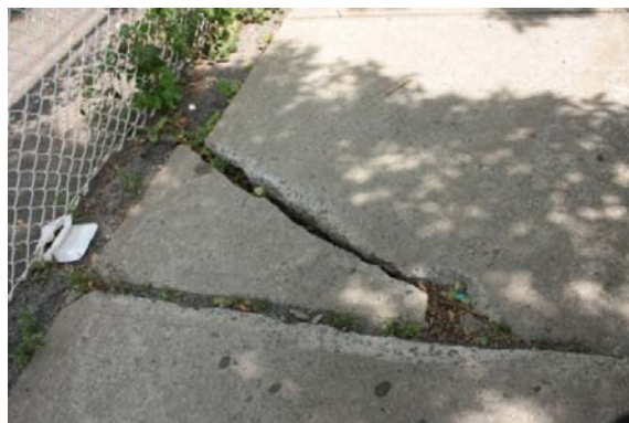
Trottoir en mauvais état
